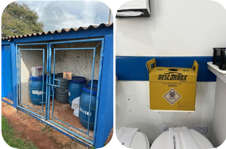
Figura 37: Acondicionamento de RSS no Hospital Municipal de Laguna Carapã.
